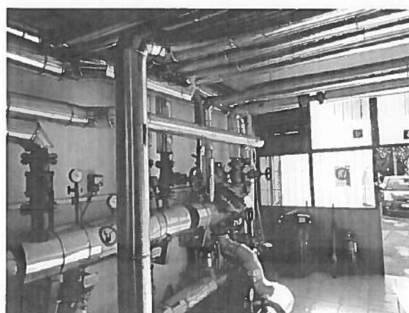
Radován téri hőközpont
